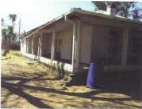
Die renovierungsbedürftige Dorf-Grundschule.
